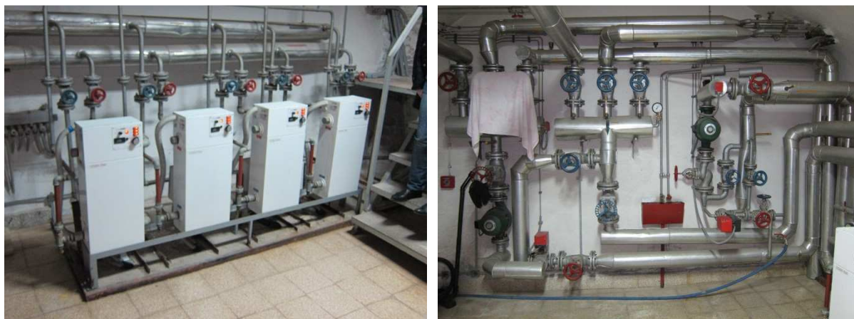
8.1. ábra Elektromos kazánok és a hőellátó rendszer
