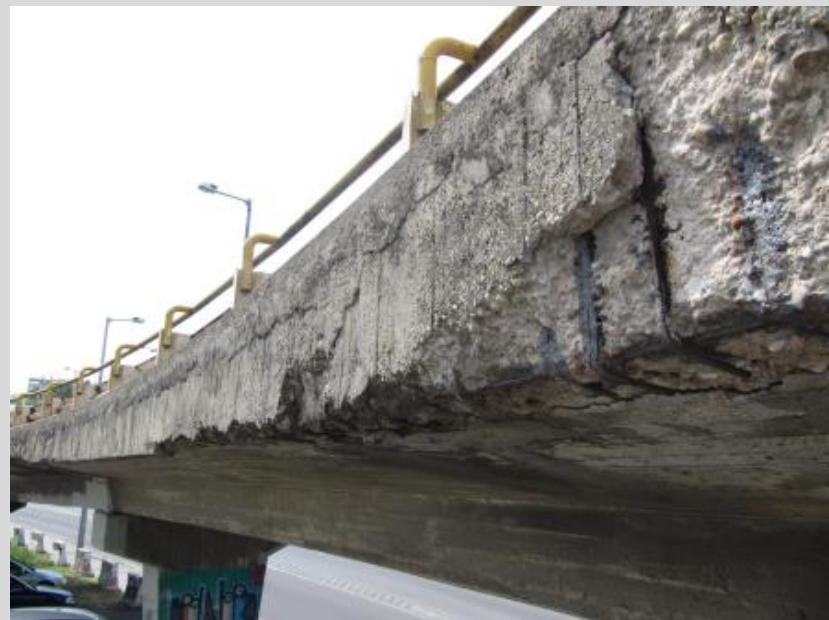
A korróziós károsodás mértéke
