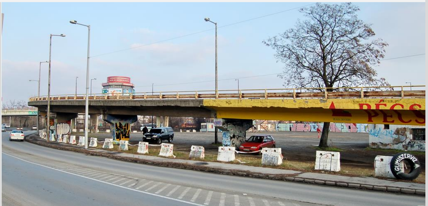
A felújítás előtt álló Pécsi Árpád Híd felhajtó ága (2011)
