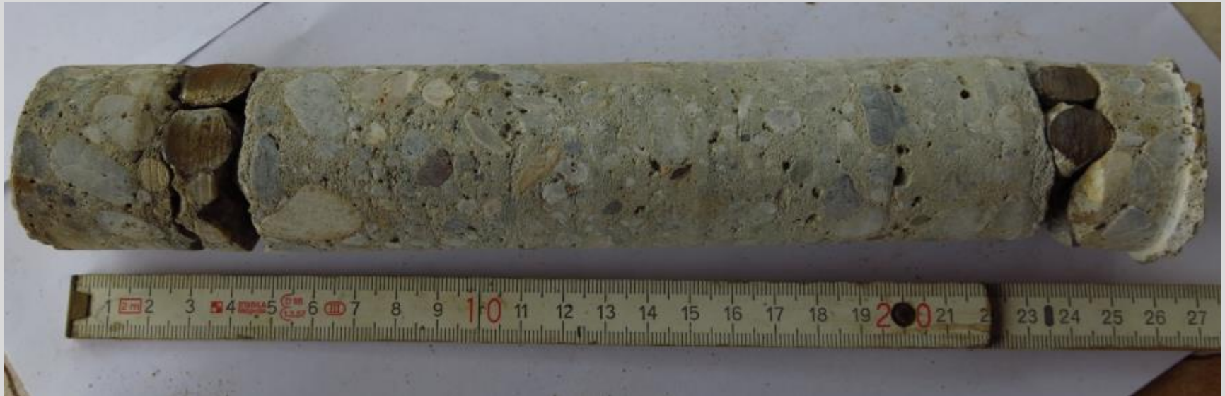
A támfalból kifúrt minta szétválása a betonacélok környezetében
