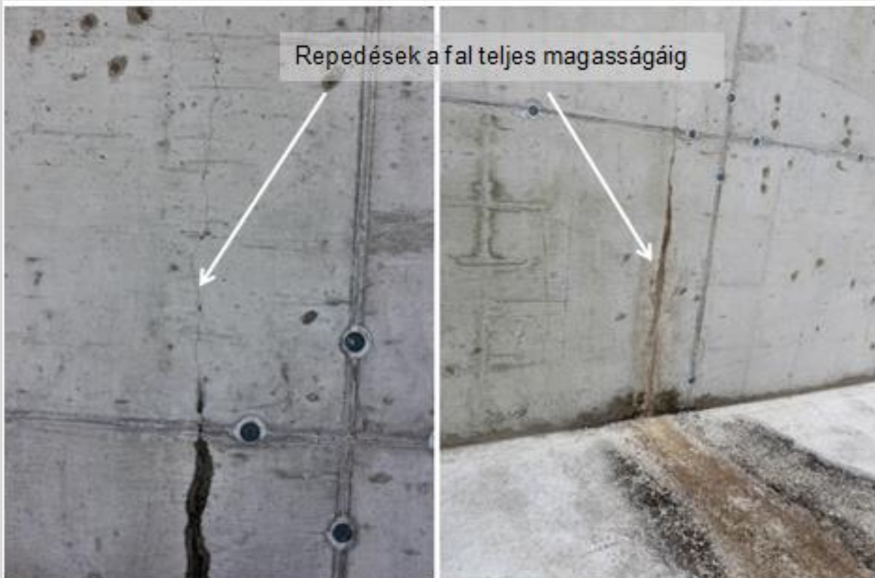
Zsugorodási repedések a támfalon és az alaplemezen
