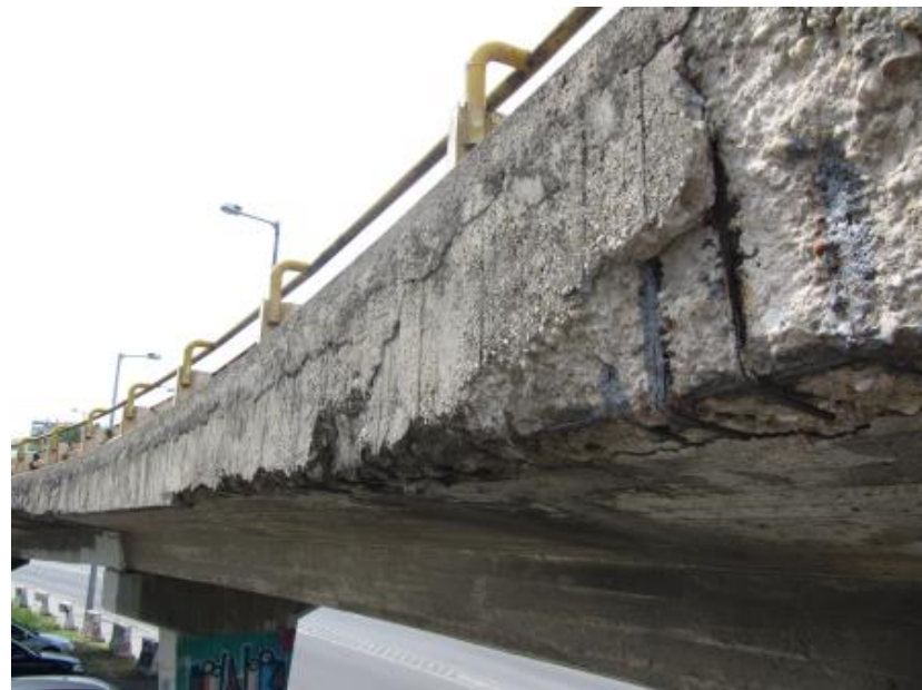
A korróziós károsodás mértéke
