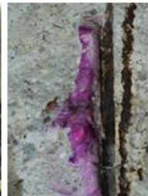
A károsodott falszerkezet
