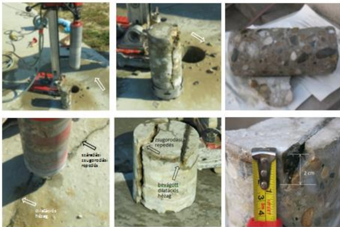
Zsugorodási (száradási) repedések és a fuga vizsgálata
