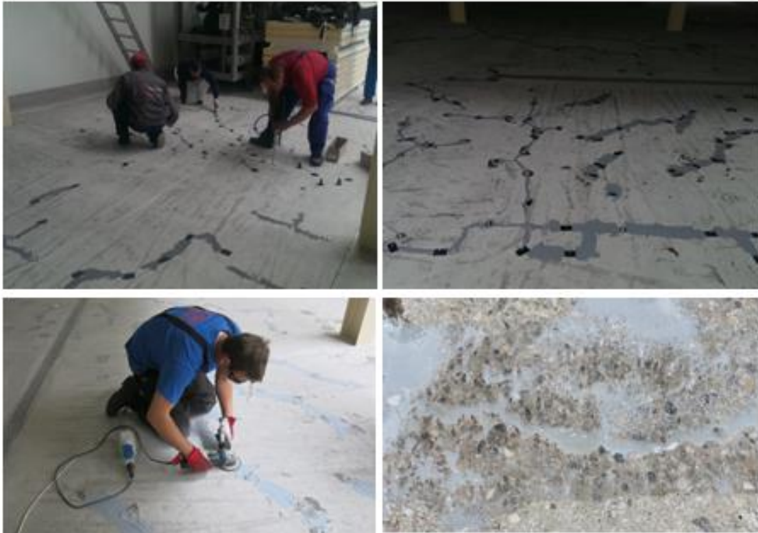
A repedezett betonajzat utólagos javítása
