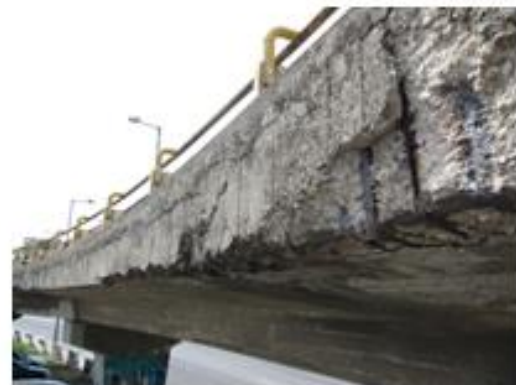
A korróziós károsodás mértéke
