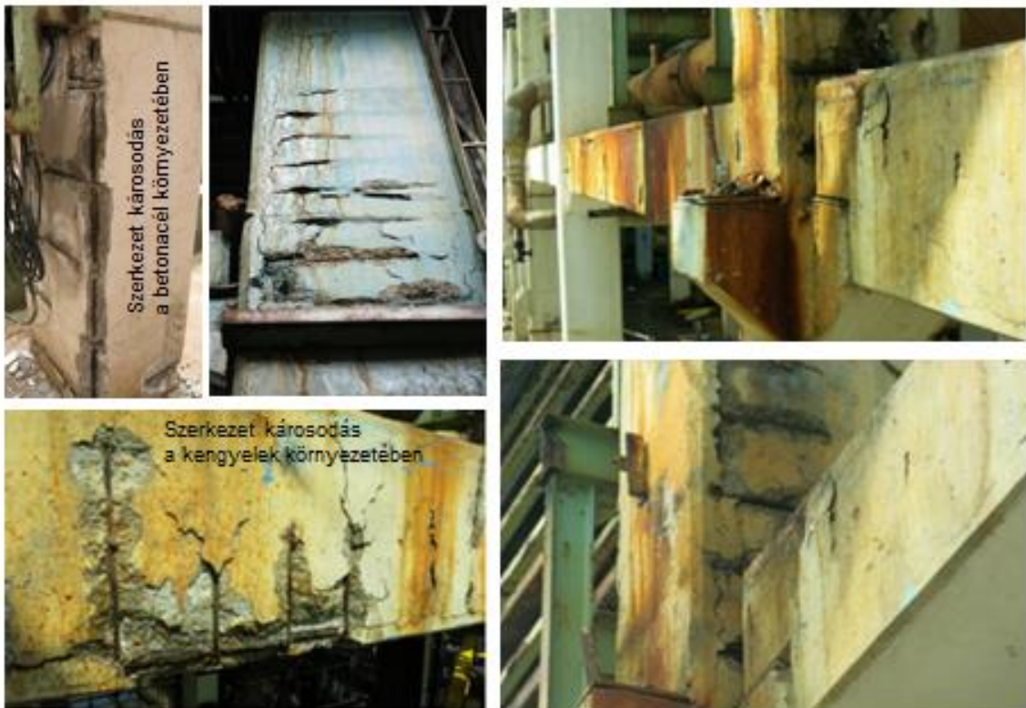
A vasbeton vázszerkezet korróziós károsodása
