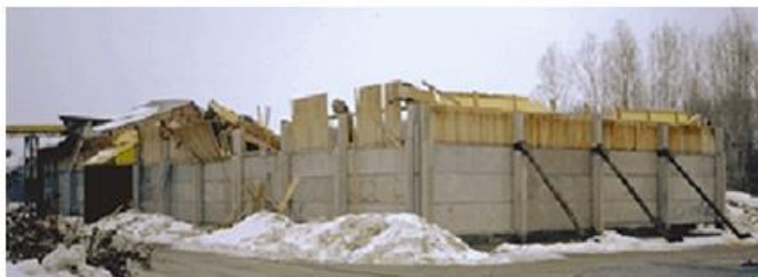
A károsodott falszerkezet és az összeomlott tetőszerkezet
