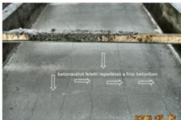
A frissen begyártott gerendafelület plasztikus repedései
