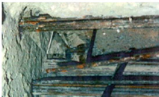
Feszítőhuzalok kloridos korróziója
