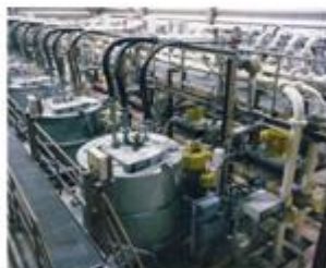
REA gipsz előállítása füstgáz kéntelenítő üzemben
