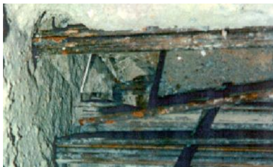
Feszítőhuzalok kloridos korróziója
