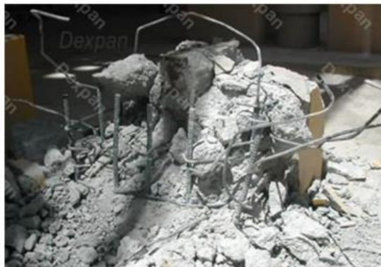
Szétroncsolt vasbeton szerkezet
