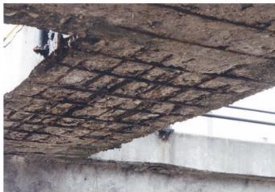
Korrodált vasbeton szerkezet
