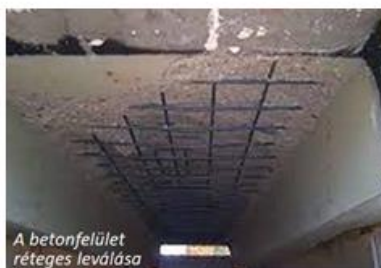
A beton réteges leválása
