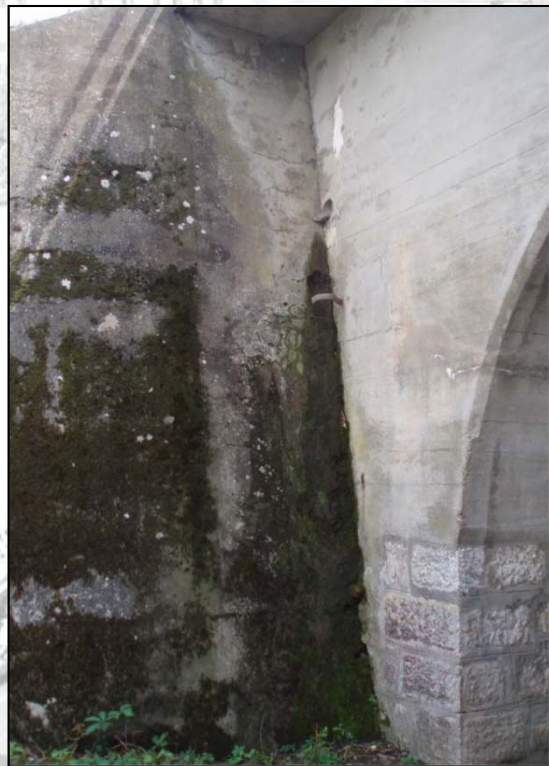
13. kép. Vasbetonszerkezetű hidak fizikai károsodása [Orbán Z. 2017]
