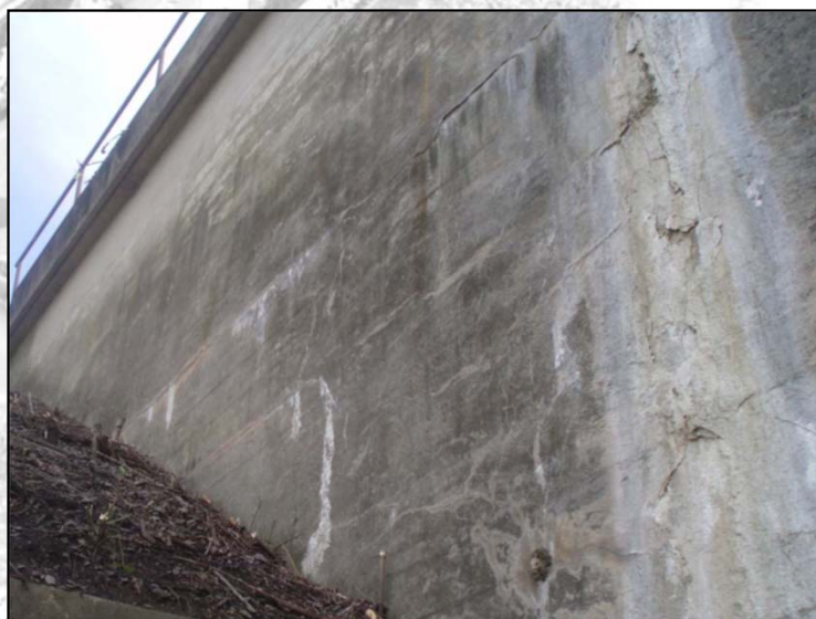
10-12. kép. Vasbetonszerkezetű hidak karbonátosodása I. [Orbán Z. 2017]
