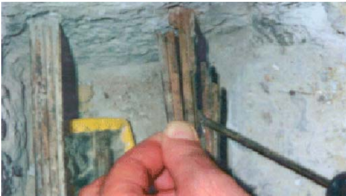
A feszítőhuzalok korróziós károsodása
