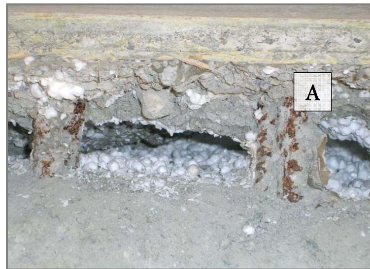
A beton kiüregelődése
