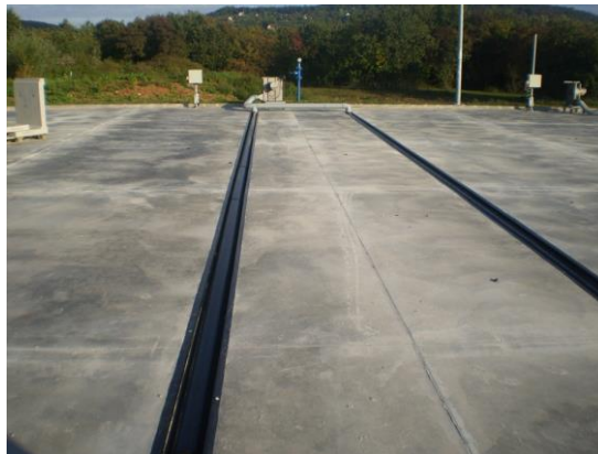
42. ábra: Térbetonban elhelyezett levegőztető cső
