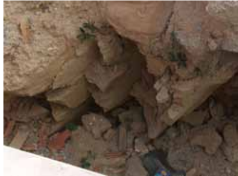
12. fénykép. Szivárgórétég kialakítására alkalmatlan márgás, sziklás talaj
