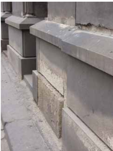
10. fénykép. Tönkremenetel a lábazon és a kapcsolódó épületszerkezeteken (fotó: Szende Árpád)
