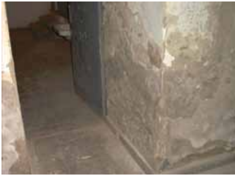
3. fénykép. Oldalfal padló közeli részének erős nedvesedése (létrejöttében valószínűsíthető az épületgépészeti vezetékmeghibásodás közrehatása!)
