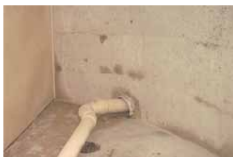
10. fénykép. A pince íves határoló betonfalán átszivárgó víz nyomai
