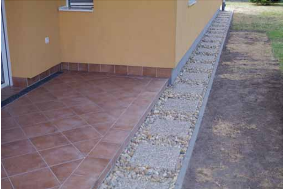
12. fénykép. Épület körüli szivárgó járda beton tipegőkkel, a felszíni víz közvetlen ráfolyását meggátoló kissé kiemelt beton szegélykő sávval (fotó: TE)
