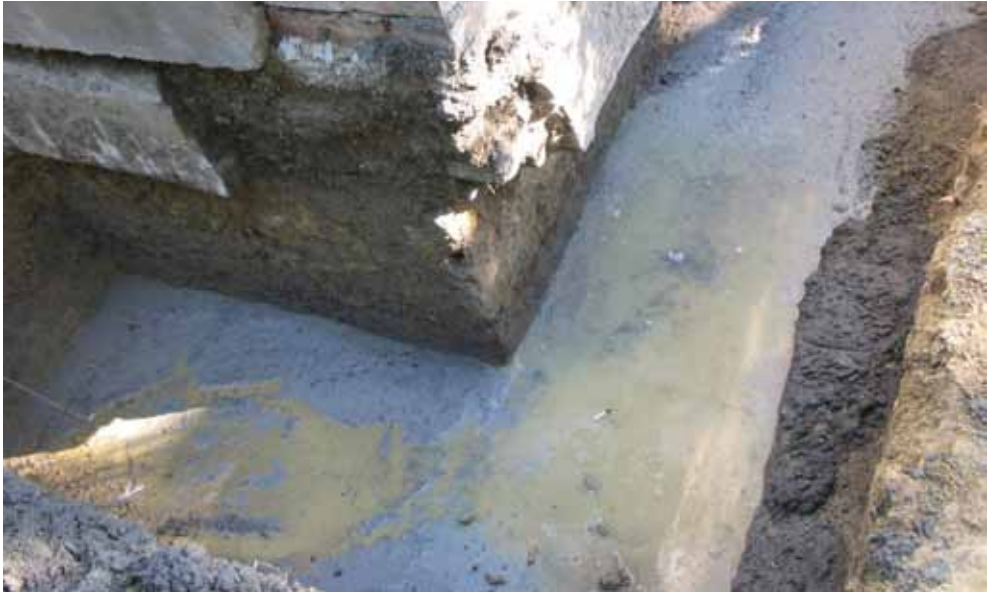
4. fénykép. A déli épületsarok a kiváltó acélgerenda bebetonozása után (A felperes felvétele 2005. 04. 28-án)
