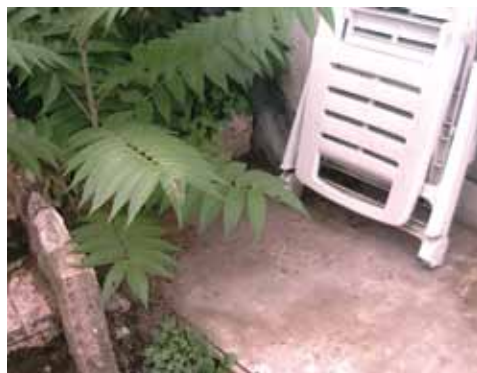
16. fénykép. Az épület mellett közvetlenül gyökeret eresztett növényzet
