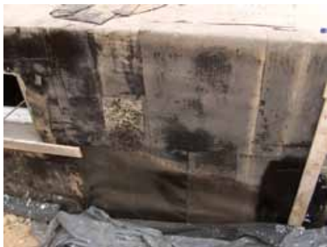
1. fénykép. Pincefal hullámos, rögzítetlen bitumenes lemezszigetelése, aljzatproblémákkal
