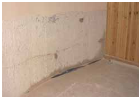
6. fénykép. A pince íves határoló fala vakolatlevegés után láthatóvá váló vízbetöréssel
