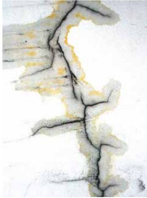
43. fénykép. A csapadékvíz-szigetelés meghibásodásából eredő beázás, és festési, fogadószínti repedés nézete
