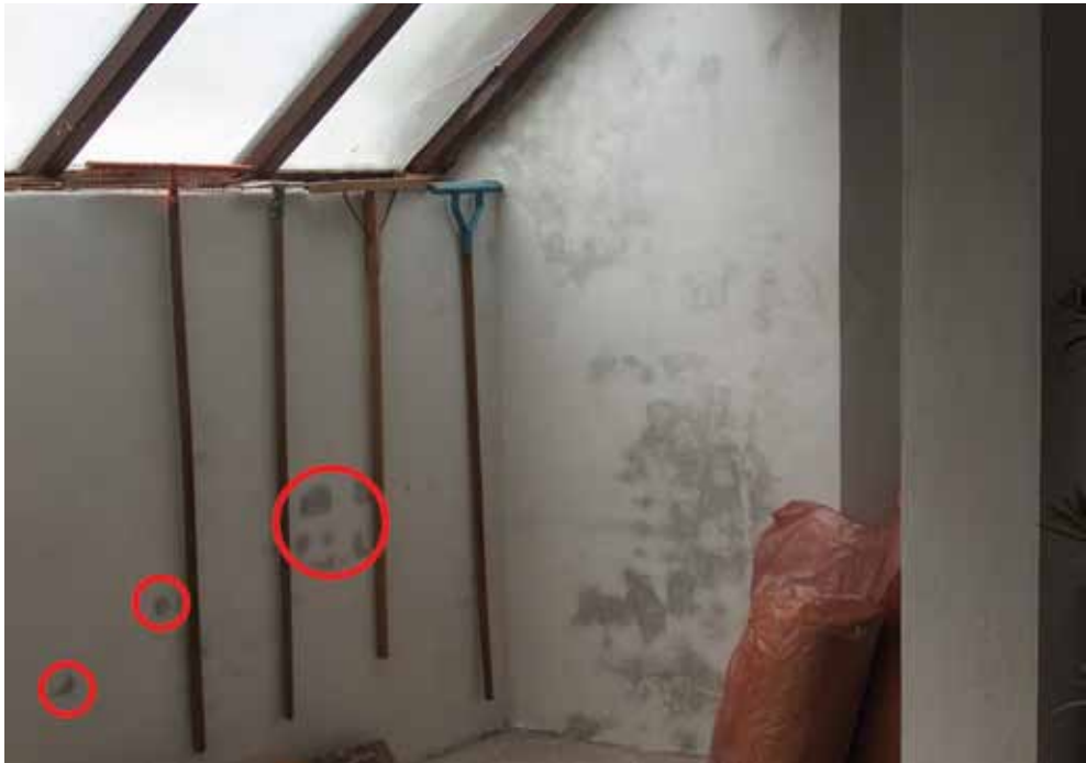
11. fénykép. A medencetér oldalfalának vizesedése – oka: a teraszburkolat, illetve a földdel érintkező külső falak vízszigetelésének meghibásodása
