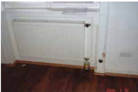
15. fénykép. Új lapradiátor rögzítetlen csővezetékekkel, csepegő radiátorszeleppel
