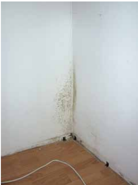
10. fénykép. Penészesedés a belső festett falfelületeken
