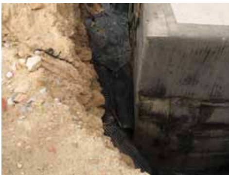
2. fénykép. Pincefal rosszul rögzített bitumenes lemezszigetelése
