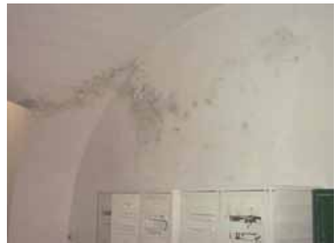
18. fénykép. Külső fali boltváll nedvesedése
