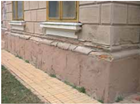
21. fénykép. Részlet a kiugró kőlábazat felett szétfagyott, töredezett utólagos cementsimítással
