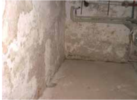
6. fénykép. Pinceoldalfal nedvesedése – gépészeti hibák (csatornavezetékek tömítetlensége, csöpögése, falazaton történő szakszerűtlen átvezetések) közrehatása valószínűsíthető
