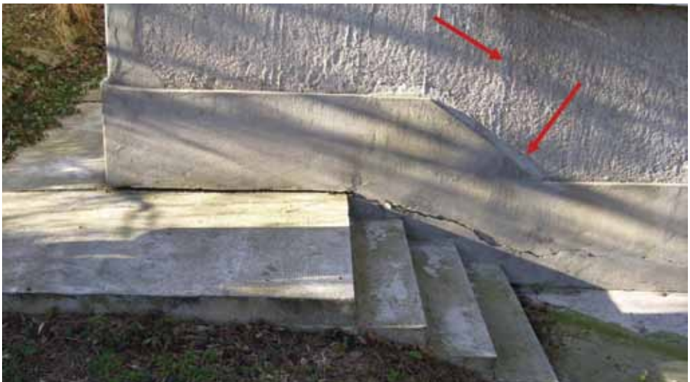
9. fénykép. A megerősített déli épületsarok nézete a délkeleti homlokzat felől. A hibásan kivitelezett új járda megsüllyedése miatt kialakult repedéseken keresztül a csapadékvíz az épület lábazati falát közvetlenül terheli. A sarok környezetében szerkezeti süllyedésre utaló repedések, illetve azok javításának nyomai nem láthatók. A piros nyilakkal jelölt helyeken a lábazati vakolat, illetve a homlokzat túlsó, keleti sarkának mozgására utaló hajszálrepedések láthatók, melyeket a felújítás során egyszerű kikenéssel javítottak. (A szakértő felvétele 2008. 01. 31-én)
