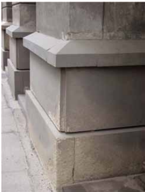
24. fénykép. Felületek eltérése a tervezettől (fotó: Szende Árpád)
