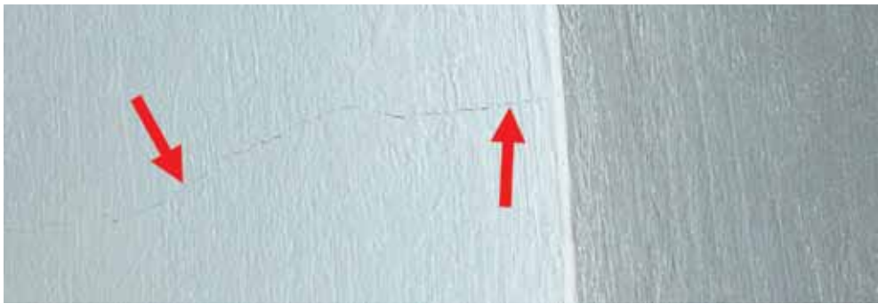
8. fénykép. Alapsüllyedésre utaló vízszintes repedés a garázs feletti lakás belső főfalán
