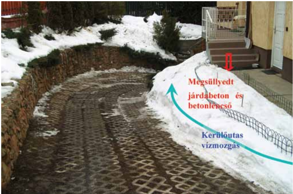
2. fénykép. Az elemekből rakott garázslejáró és az épület körüli járda megsüllyedt, megbillent betontáblái, melyek a járda alatti földfeltöltés roskadását, tömörödését jelzik
