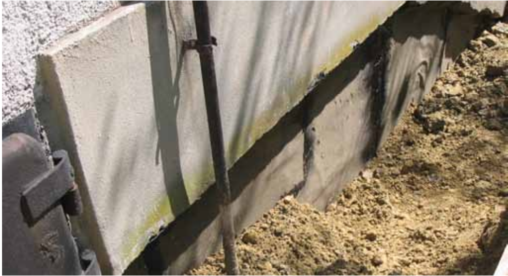
6. fénykép. A lábazat utólagos bitumenes lemez szigetelése, védőréteg nélkül visszatöltött törmelékes helyszíni agyagtalajjal, tömörítés nélkül (A felperes felvétele 2005. 04. 27-én)
