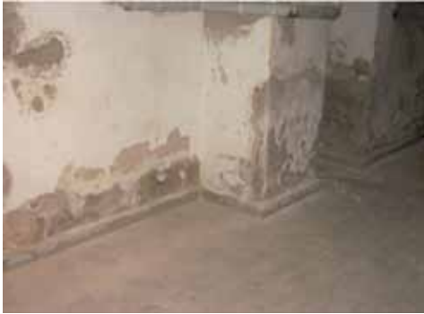
1. fénykép. Külső fal padló és oldalsó talaj felől érkező nedvességkárosodása (pincében)
