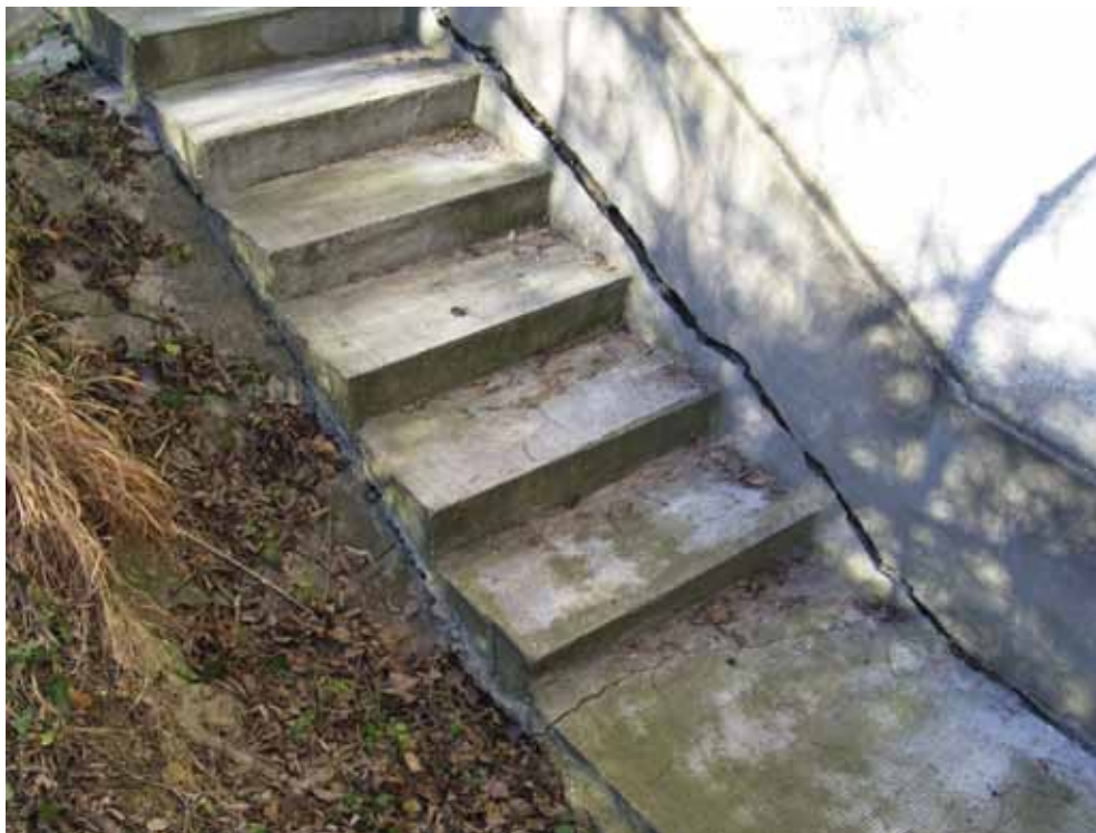
2. fénykép. Tereplépcső megsüllyedése (fotó: TE)
