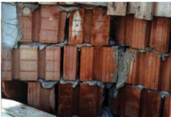
12. fénykép. A falazat mint fogadósztint nem megfelelő kialakítása (fotó: Szende Árpád)
