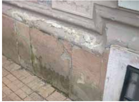
20. fénykép. Lábazati részlet, a lábázat vonala felett átnedvesedett, kifagyott vakolattal
