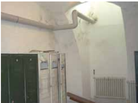
17. fénykép. Külső fali boltváll és parapetfal nedvesedése – feltétlenül közrehat a csőátvezetés szakszerűtlen szigetelése is!
