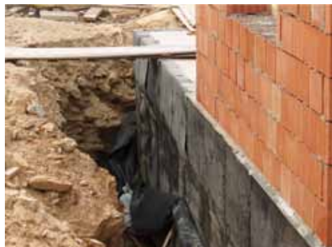
4. fénykép. Pincefal rosszul rögzített, bitumenes lemezszigetelése, lemezillesztési hibákkal, hibás drénlemez-beépítéssel
