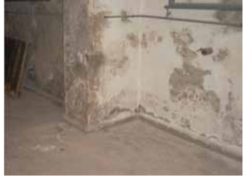
2. fénykép. Külső fal padló és oldalsó talaj felől érkező nedvességkárosodása (pincében)
