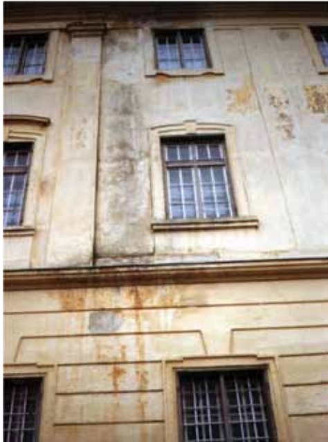
42. fénykép. Bádogos szerkezetek, csatorna, párkányfedés meghibásodása folytán létrejött elszíneződések, homlokzatvakolati tönkremenetek (fotó: Szende Árpád)
