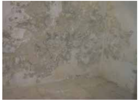
4. fénykép. Oldalfal padló közeli részének erős nedvesedése (létrejöttében valószínűsíthető az épületgépészeti vezeték meghibásodás közrehatása!)
