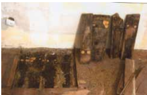
11. fénykép. Nedves, dohos, részben korhadó vakpadló, elszíneződött, nedves párnafa és sötét színű vizes salak/homok aljzatkeverék közvetlenül a bontást követően
