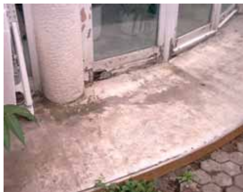
14. fénykép. Befelé lejtő járda, a folyamatos vizesedéstől korhadó küszöbök
