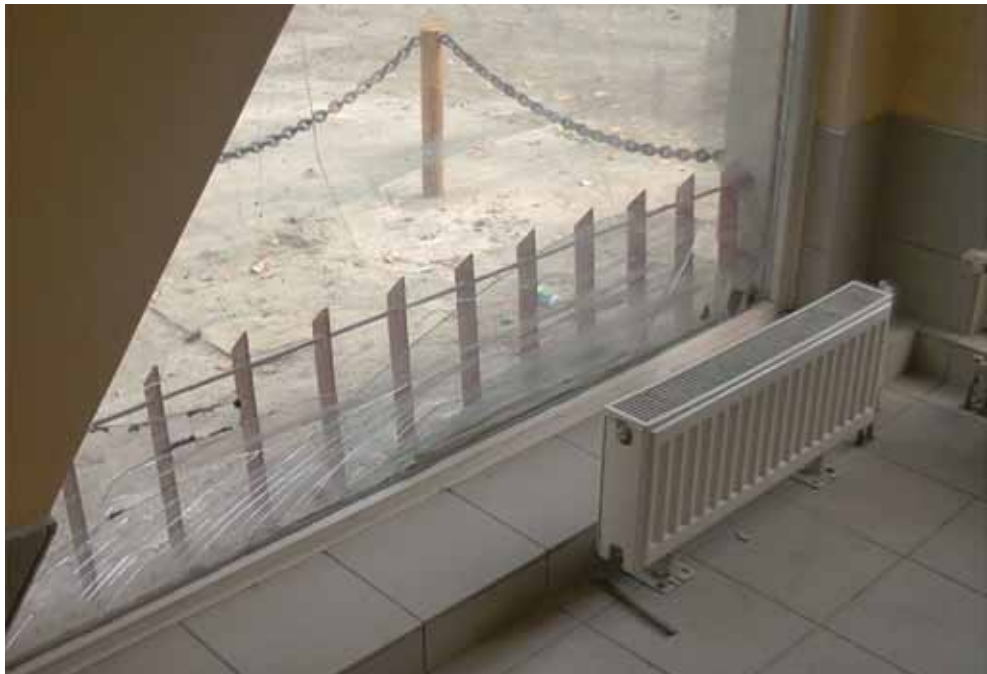
3. fénykép. Víznyomás által megroppantott biztonsági üvegtábla
