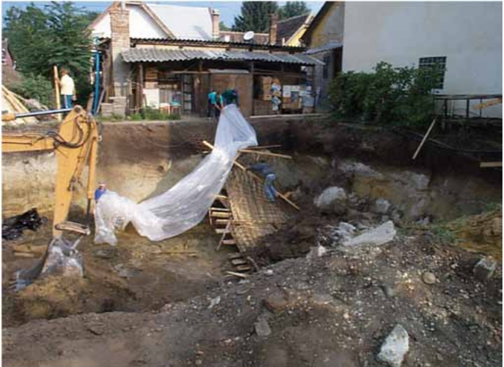
4. fénykép. A hátsókerti függőleges földfal beomlása maga alá temette a vasszerelést és a belső oldali zsaluzatot (fotó: az építető)
