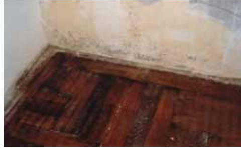
8. fénykép. Az eredeti parkettaburkolat a belső falsarokban, nedvességtől elszíneződött faanyaggal, a falzatba felszívódó vízesedés látható jeleivel, kezdődő penészedéssel
