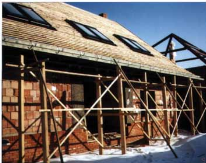
1. fénykép. A külső vakolat teljes hiánya (fotó: Szende Árpád)
