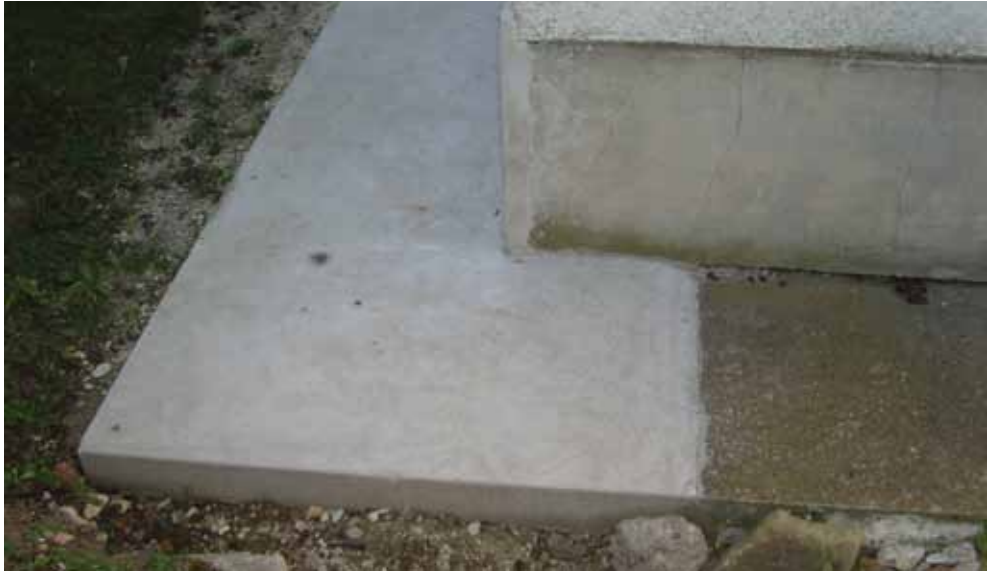
3. fénykép. Tereplépcső megsüllyedése (fotó: TE)
