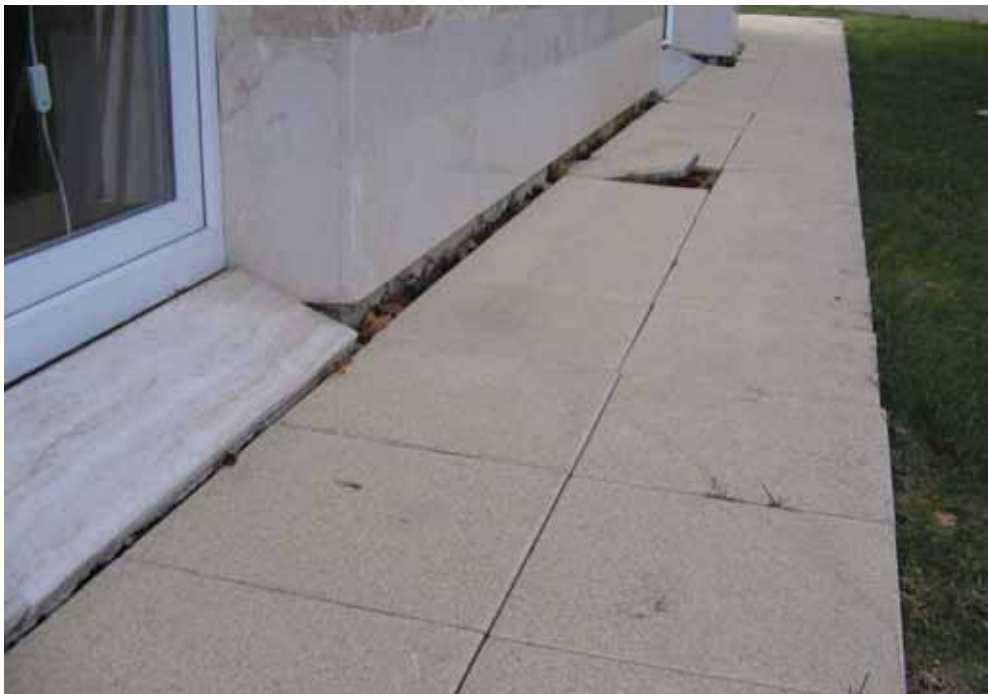
7. fénykép. Elemekből rakott járda süllyedése (fotó: TE)
