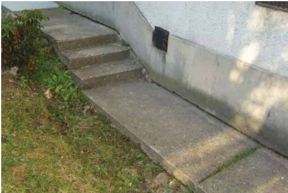
1. fénykép. Monolit betonjárda megsüllyedése (fotó: TE)
