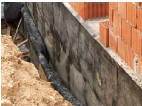
3. fénykép. Pincefal hullámos, rögzítetlen bitumenes lemezszigetelése, hibásan elhelyezett drénlemezsel
