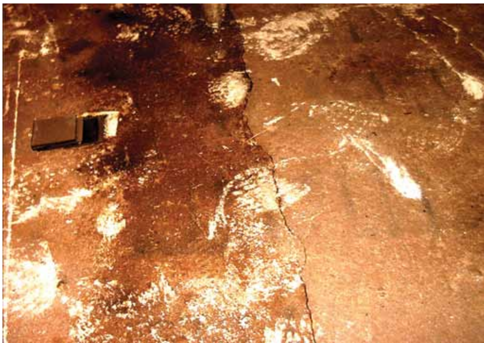
1. fénykép. Vonal mentén megrepedt betonpadló
