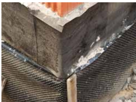
5. fénykép. Pincefal bitumenes szigetelése, hibás drénlemezbeépítéssel
