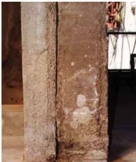
25. fénykép. Nem megfelelő hőmérsékleten betonozott, és korán kiszaluzott, kifagyott vasbeton pillér nézete (fotó: Szende Árpád)
