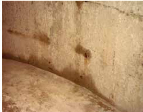
2. fénykép. A pince íves határoló fala vakolatleverés után láthatóvá váló vízbetörési helyekkel
