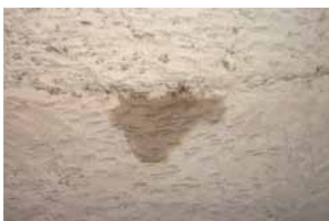
9. fénykép. A pince beton határfalán átszivárgó víz nedvességképe
