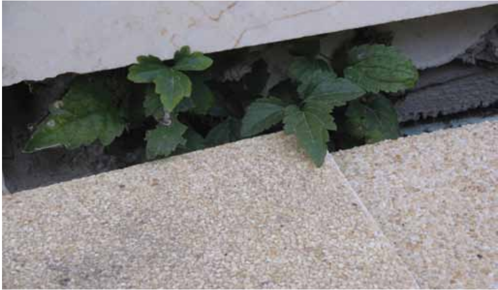
6. fénykép. Járda betonlapjainak egyenlőtlen mértékű, jelentős süllyedése (fotó: TE)
