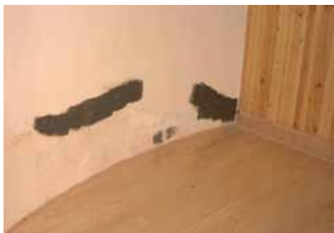
5. fénykép. A pince íves határoló fala vakolva és bitumenes kenéssel ellátva – sókivirágzással
