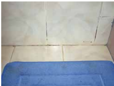
9. fénykép. Penészesedés jelei a belső csempeburkolaton
