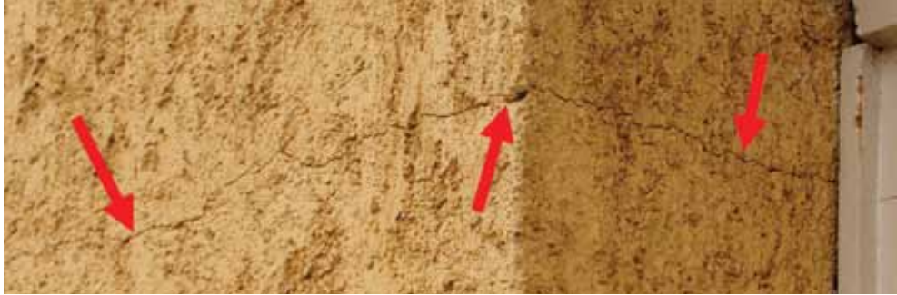
7. fénykép. Alapsüllyedésre utaló vízszintes repedés a garázs feletti lakás bejárati ajtaja melletti főfalán
