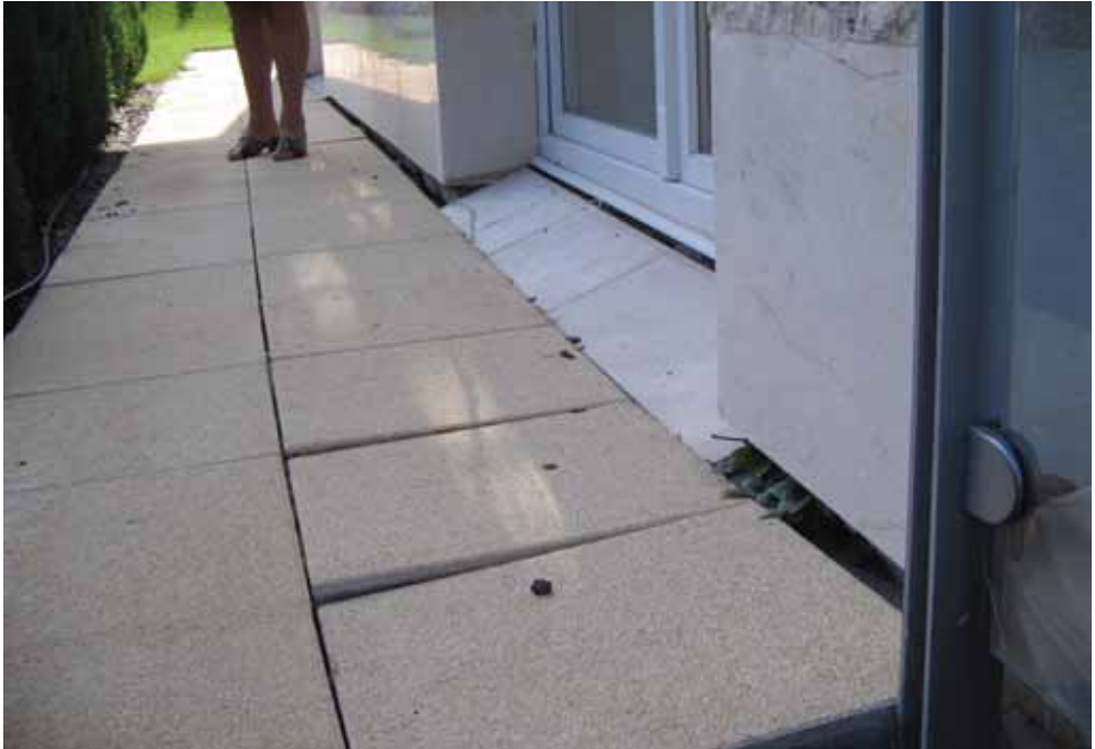
8. fénykép. Elemekből rakott járda lapjainak süllyedése. A homlokzati kőburkolat méretrendjéhez illesztett kőlap küszöb eredetileg vízszintes helyzetű volt (fotó: TE)
