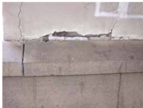
28. fénykép. Megengedtnél nagyobb hézagszélesség és síkfogasság nézete (fotó: Szende Árpád)
