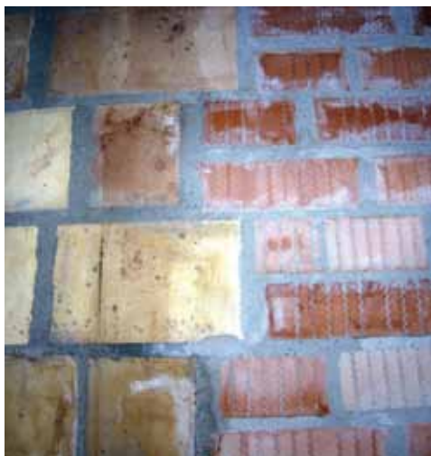
21. fénykép. A téglák geometriai hibái, no meg a válogatatlan elemekkel, gondatlan falazás miatti nem megfelelő nyers téglafal (fotó: Szende Árpád)
