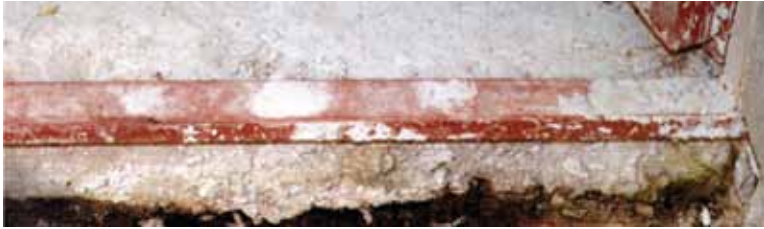
18. fénykép. Acél nyílászáró, belső vakolási anyaggal és betonnal szennyezett (fotó: Szende Árpád)
