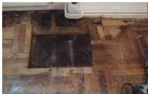
12. fénykép. Erősen nedves, elszíneződött feltöltés, vakpadló és párnafa a radiátorszelep alatt
