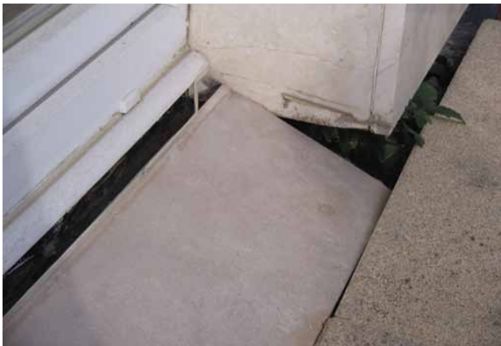
5. fénykép. Épület körüli járda és csatlakozó kő „küszöb” megsüllyedése (fotó: TE)
