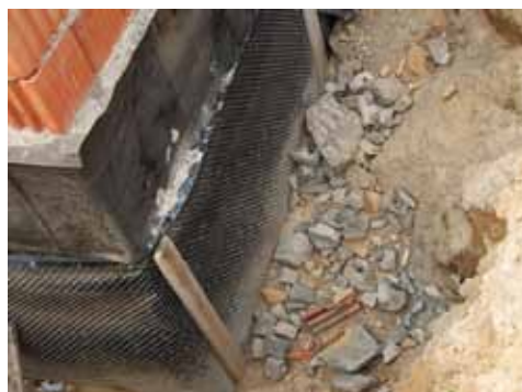
6. fénykép. Hibás drénlemezbeépítés, alkalmatlan (építési törmelék) visszatöltéssel
