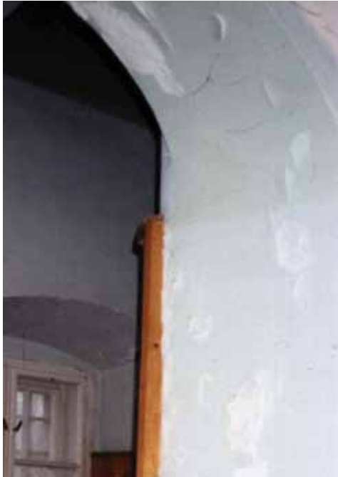
30. fénykép. Belső műanyagfestés leveles leválása (fotó: Szende Árpád)
