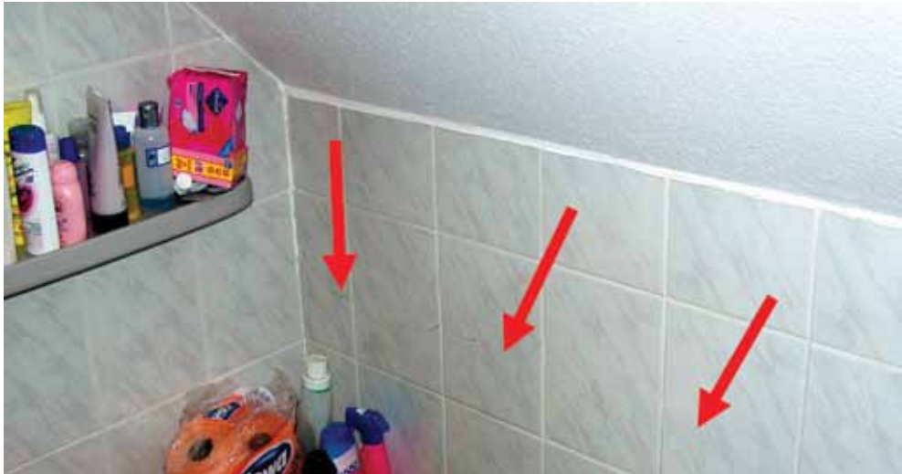
4. fénykép. Vízszintes repedés a tetőtéri fürdőszobában, csempén keresztül, a térdfal mentén
