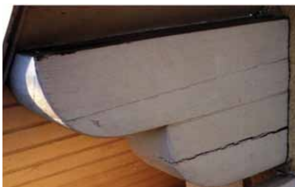
14. fénykép. A felületképzés hordozó szerkezetének felrepedései a mázolás repedéseit okozták (fotó: Szende Árpád)
