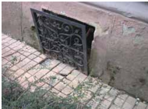
7. fénykép. A keramitlap elemes járdaszintje magasabb a feltételezett korábbi járdaszintnél, a csapadékvíz becsorog a szellőzőablakon
