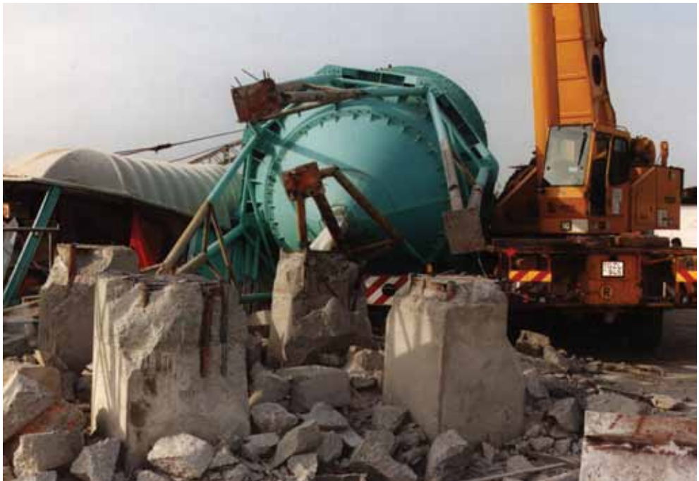
34. fénykép. Szigetszentmiklósi iroda-öltöző épület tönkremenetele silóborulás következtében
