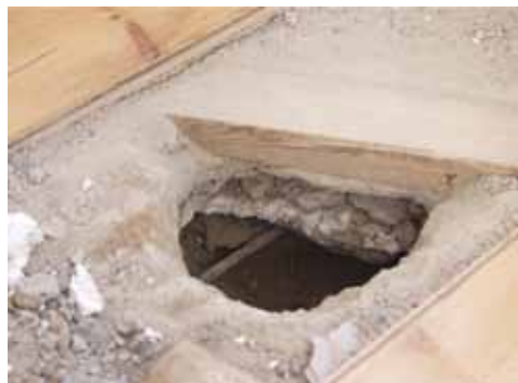
14. fénykép. Nappali hajópadló burkolatú talajon fekvő vízszigetelés nélküli 2. jelű padlófeltárás nézete
