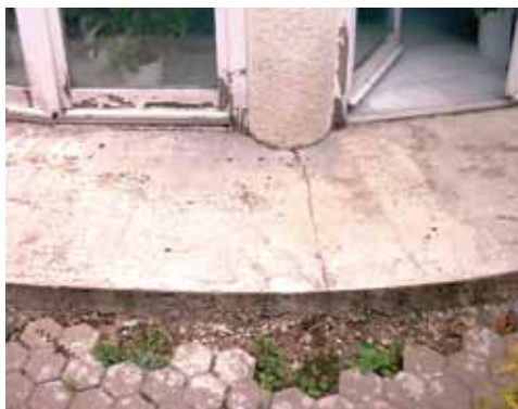
13. fénykép. A „téli kert” teraszajtóküszöbjei felé (befelé) lejtő járda
