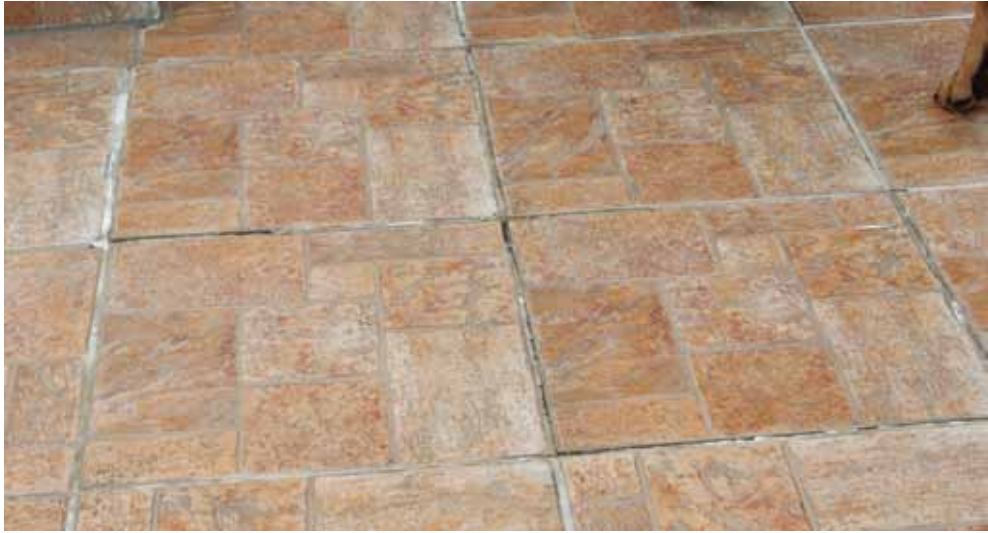
10. fénykép. A medencetér feletti terasz burkolatának repedései a külső lépcsőcsatlakozásnál – oka: a tereplépcső alapozásának megsüllyedése (a csőtörés áttételes következménye)
