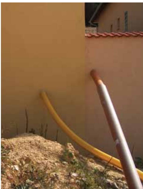
8. fénykép. Átgondolatlan, szakszerűtlen dréncső- és esővízgyűjtőcső-kivezetés az utcára
