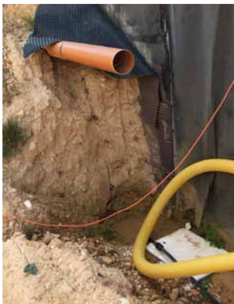
7. fénykép. Működésképtelen drénlemez, átgondolatlan vízvezetés
