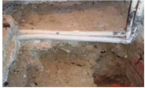
14. fénykép. Meglévő régi lapburkolatra rábetonozással kialakított új lapburkolat, a felbetonban vezetett fűtési csővezetékekkel, a régi burkolat alatt nedves aljzatbetonnal, alatta töredezett, előregedett bitumenes lemez szigeteléssel, az alatt vizes, morzsolható aljzatbetonnal és vizes talajjal. A tömör téglal oldalfal erősen vizes, vízszintes falszigetelés a feltárásban nem látható.
