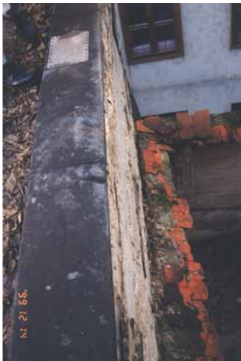
48. fénykép. A téglafal (kerítés) cserépfedésének, és bádogozásának javítási elmaradásai szinte a teljes szerkezet tönkremeneteléhez vezettek (fotó: Szende Árpád)
