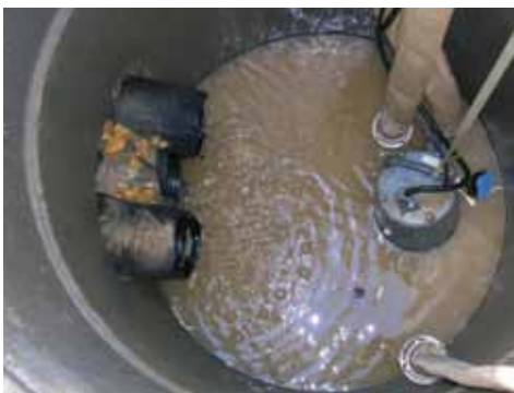
8. fénykép. Drén vezeték aknája búvárszivattyúval. 2006. 05. 25.
