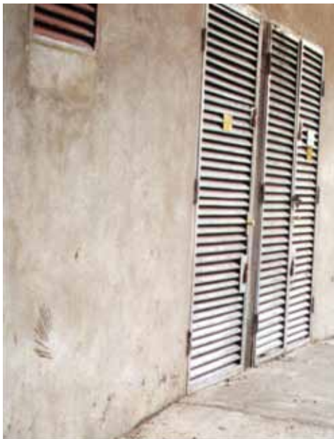
9. fénykép. A tűzihorganyzott acélfelületek helyett részben alapmázolás és majdan további mázolási rétegek készültek volna (fotó: Szende Árpád)
