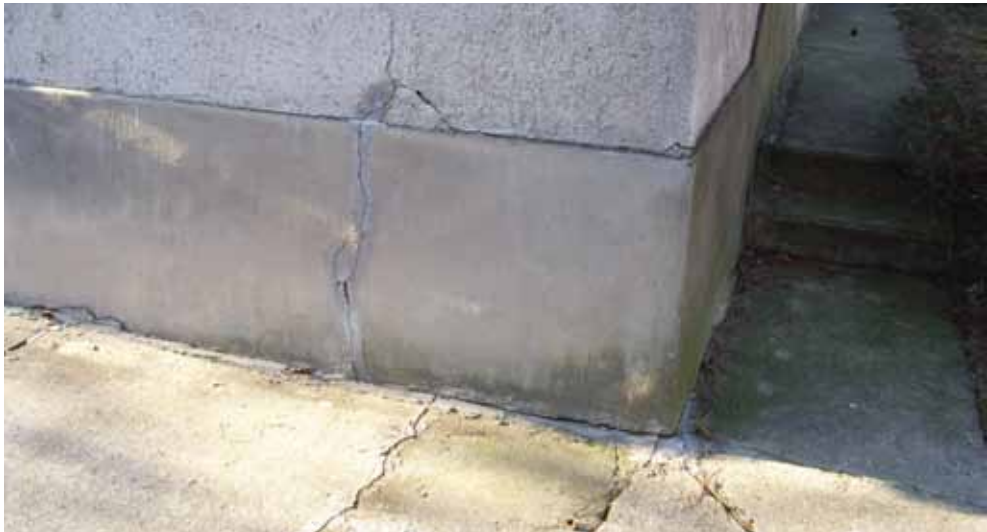
4. fénykép. Járdabeton károsodásának közvetett következményei (fotó: TE)
