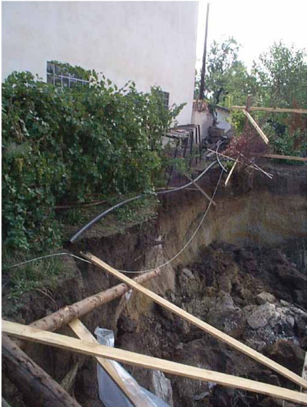
3. fénykép. A hátsókerti függőleges földfal beomlása (fotó: az építető)
