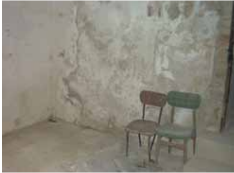
5. fénykép. Pinceoldalfal nedvesedése – gépészeti hibák közrehatása valószínűsíthető
