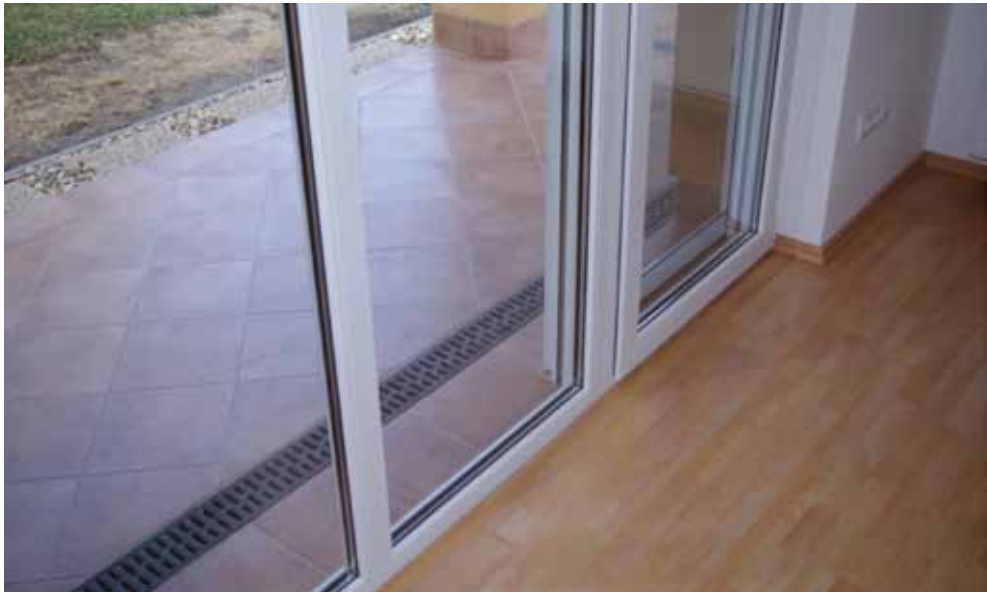
13. fénykép. Épület körüli szivárgó járda beton tipegőkkel, és a teraszajtó előtt végigfutó víznyelő rács (fotó: TE)
