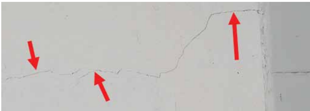
9. fénykép. Alapsüllyedésre utaló vízszintes repedés a pincszinti válaszfalán (lásd még a 3/1.1. ábrán)
