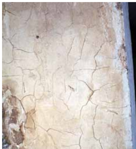
22. fénykép. A belső vakolat repedezettsége a nem megfelelő anyagösszetétel miatt (fotó: Szende Árpád)
