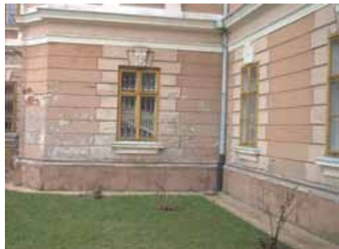
24. fénykép. Udvari belső épületsarok lábazati részlete, a lábázat felett ázó, málló homlokzatfelülettel
