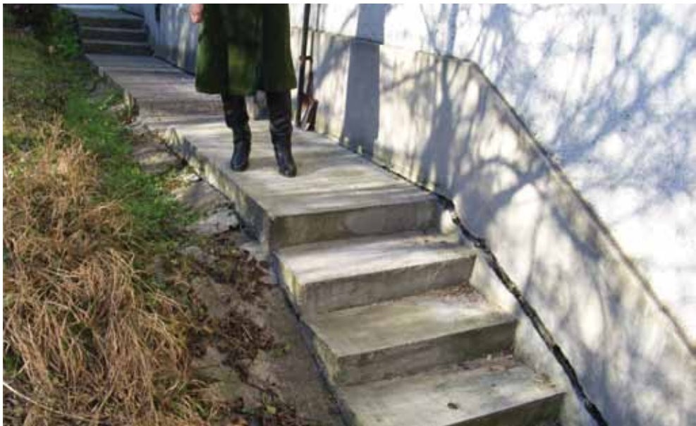
7. fénykép. A felperes által készített új járda és lépcső, szivárgó és övárok nélkül, az 3/3.5. és 3/3.6. fényképek tanúsága szerint tömörítetlen agyagos visszatöltésre, kavicságyazat nélkül visszaépítve. Állapota ma, 3 év után valamivel rosszabb, mint az eredeti több évtizedes meghibásodott járdáé (l. a fénykép háttérben) – a szakértő felvétele 2008. 01. 31-én.
