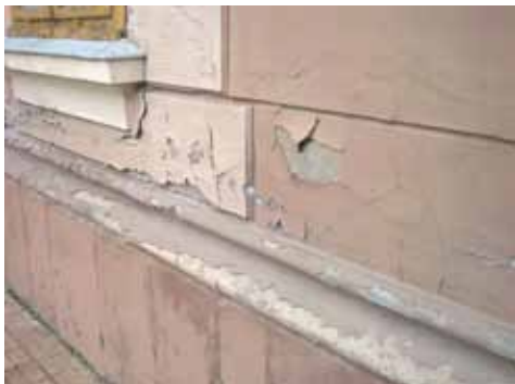
23. fénykép. Lábazati részlet, levelesen leváló párazáró felületi festéssel
