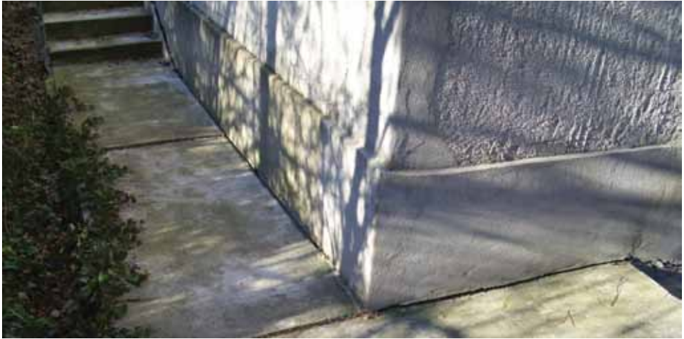
8. fénykép. A megerősített alapozású déli sarok a hibásan kivitelezett új járdával. A sarok környezetében vakolatjavítás és lábazatvakolás javítása látható. A sarok szerkezeti süllyedésére utaló repedéseknek, illetve azok utólagos javításának a sarok közvetlen környezetében nincs nyoma. (A szakértő felvétele 2008. 01. 31-én)
