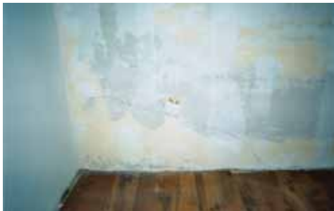
9. fénykép. Belső falsarok nedvességtől elszíneződött laminált padlóburkolattal, a falzatba felszívódó víz nyomával
