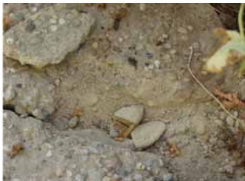
13. fénykép. Betonjárda tönkremenetelének nézete
