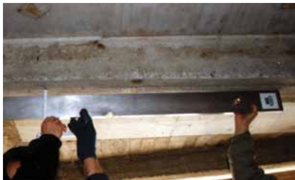
24. fénykép. A vasbeton földemgerenda nem megfelelő kialakítása (fotó: Szende Árpád)
