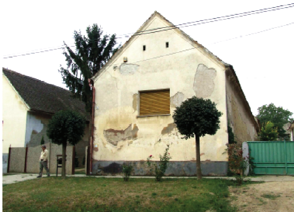
Áttekintő kép az utcai homlokzatról (2009-09-13) – tele repedésekkel, nem újak – lásd: jkv.
