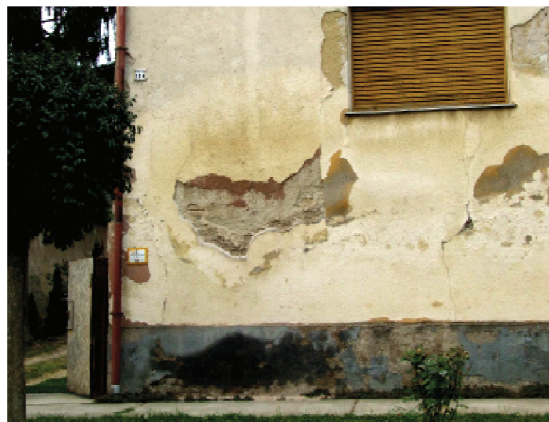
Utcai homlokzat hajszálrepedései (2009.09.13.) saroknál, ablak mellett, ablak alatt repedés, lábazaton szintén – lásd jegyzőkönyvet
