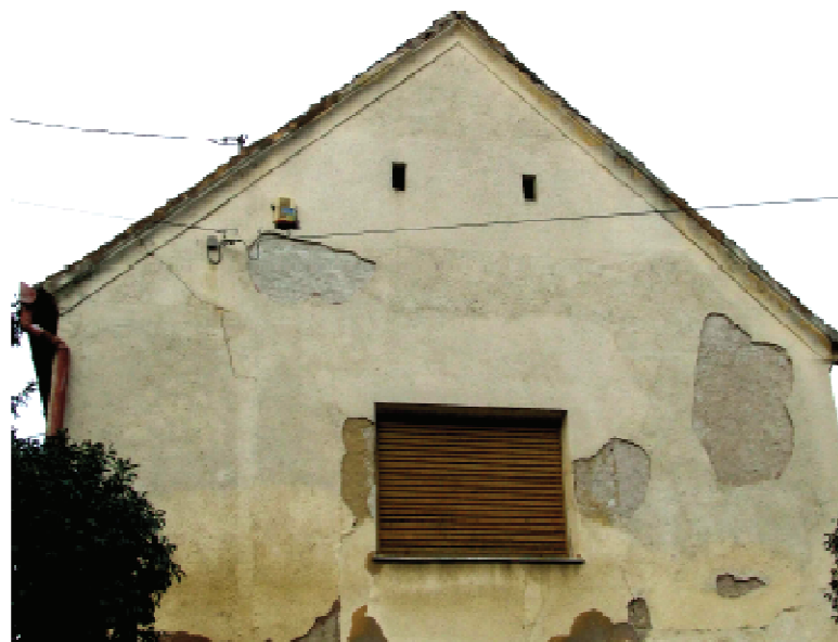
Utcai homlokzat részlete (2009.09.13.) a korábbi repedések láthatóak a homlokzaton – jkv-ben rajzolt vázlat mutatja a repedéseket
