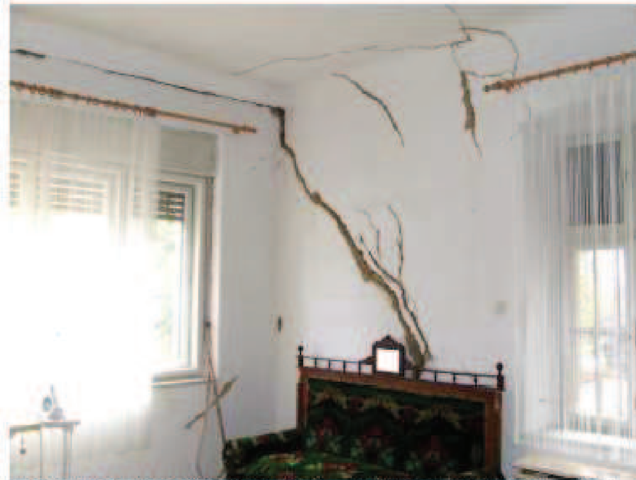
Utcai szoba déli és keleti fala (2009.09.13.) – korábban dokumentált a repedések egy része, de jóval kisebb tágassággal. Új repedések is megjelentek. A keleti fal kimozdult a függőlegesből.
