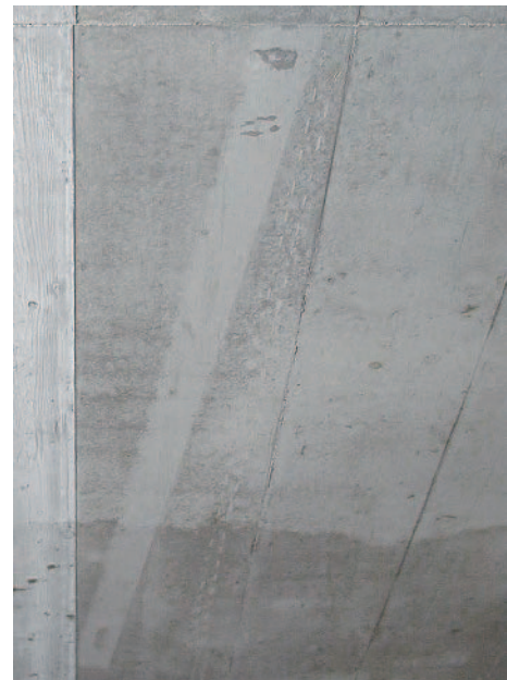
A beton elszíneződése a zsaluhéjon tárolt alulemez miatt Az erős szennyeződéseket (a szegeket, vasszerelési munkák drótjait, stb.) a betonozás előtt feltétlenül távolítsa el, ellenkező esetben a beton felületén láthatóvá válnak.
