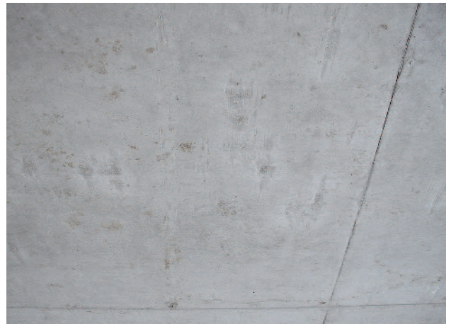
Szennyeződött födém vibrátor által okozott sérüléssel
