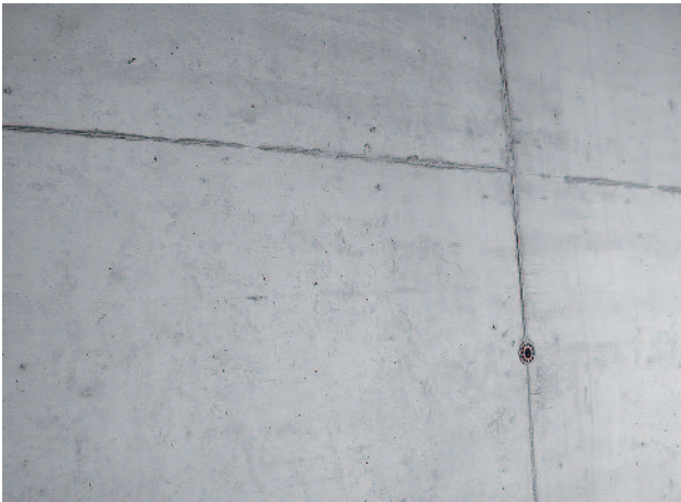
Betonozási kép: Tömítetlen elemillesztés enyhe elemelcsúzással
