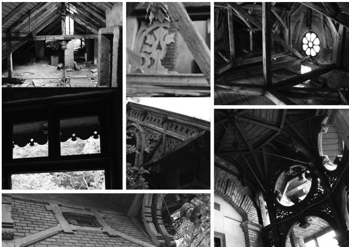
Egykori zugligeti indóház felmérése, a fotókon jól láthatók a rongálódások (Forrás: Patak Gergely)
